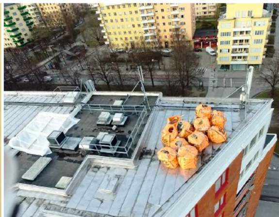
Pågående installationer med förmodade förberedelse för nytt fläkthus under presenning. Stor mängd byggsopor från utrivna installationer och borrhävar mm
