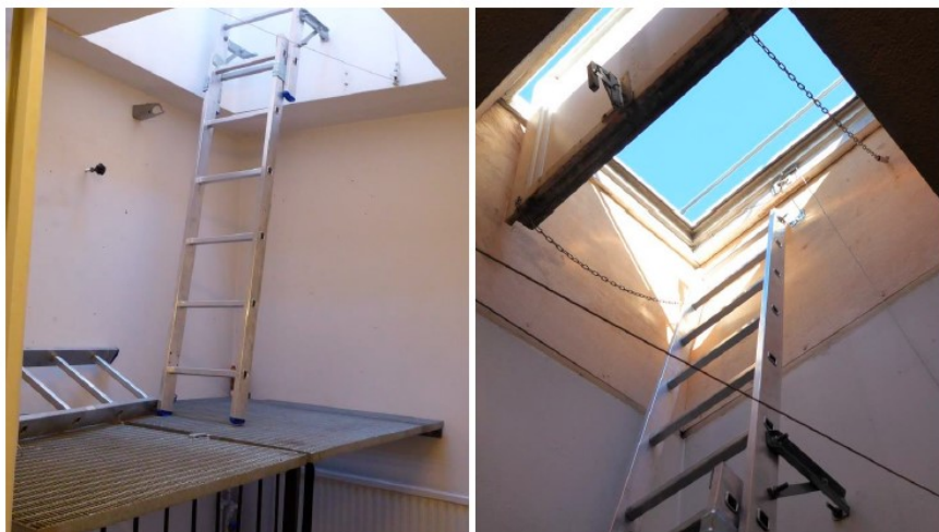
Ombyggnad av röklucka till takuppgång överst i trapphusen. Tillåtet? Bygglövsplik? De viktiga rökluckorna får ändrat användningsområde.
